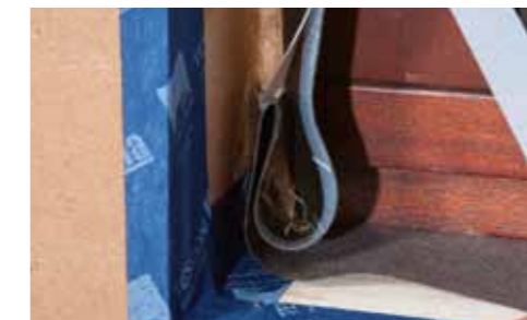
Trennfolie entfernen, Band im Eckbereich falten und untereinander verkleben. Anschließend Band umlaufend schlagregensicher und winddicht auf der Leibung verkleben. Band fest anreiben.
